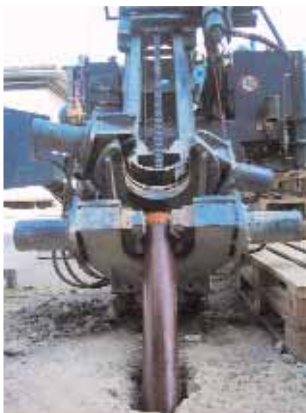
Figura 3.19 (a sinistra) - Installazione del rivestimento in PVC di un piezometro verticale. Durante la fase di discesa in foro il rivestimento è trattenuto dalle ganasce della trivella
