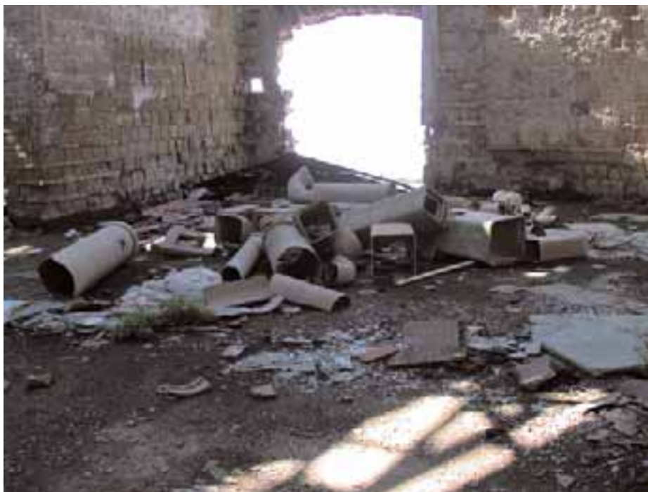
Figura 9.6 - Materiali contenenti amianto (MCA) presenti nei locali di un sito industriale abbandonato
