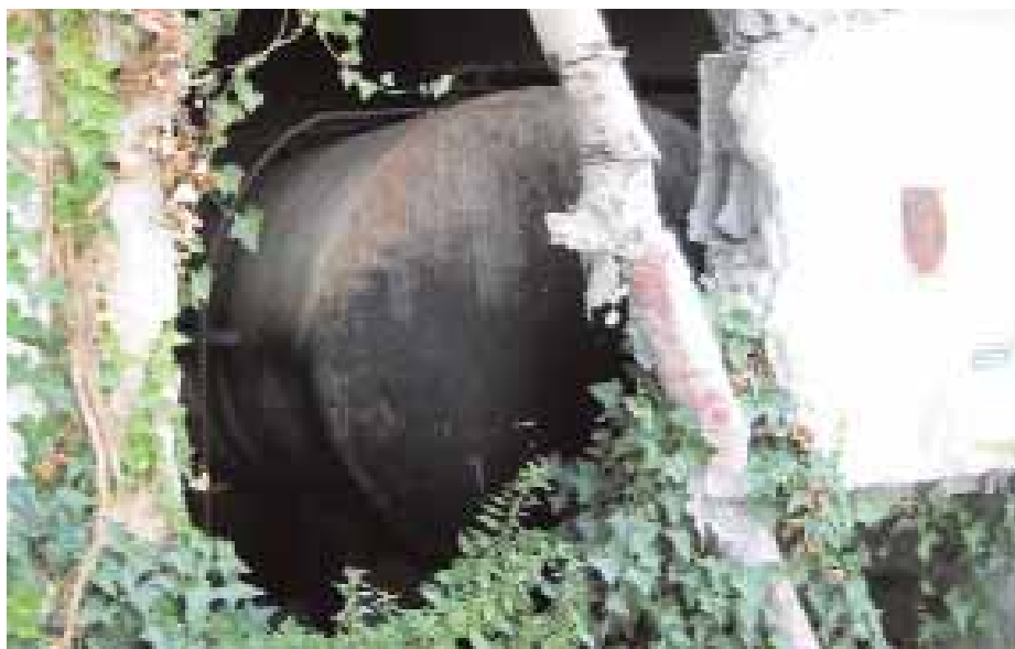
Figura 9.3 - serbatoio metallico fuori terra per gasolio da riscaldamento
