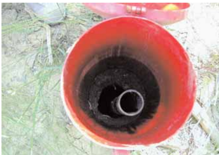
Figura 3.23 - Effetti di una cattiva sigillatura superficiale: la bentonite scollata dalla boccapozzo ha creato un vuoto attraverso il quale può infiltrarsi acqua piovana o altre sostanze
